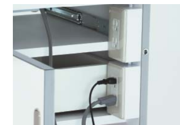
PCの電源を背面のコンセントから取れます。
